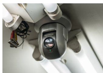
厨房の中には BB-HCM581 を設置
