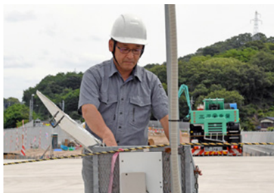
現場にネットワークカメラを設置。離れた場所からリアルタイムで状況確認が行える
